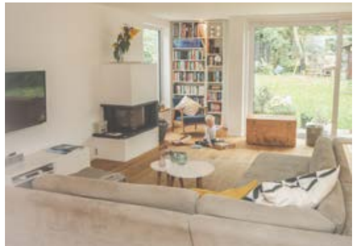
Der große Wohn-Ess-Bereich wurde in verschiedene Heizzonen unterteilt, um die Temperatur akkurat zu regulieren.
